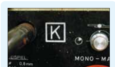
Schweißgleichrichter, der für die Verwendung unter erhöhter elektrischer Gefährdung geeignet und gekennzeichnet ist
