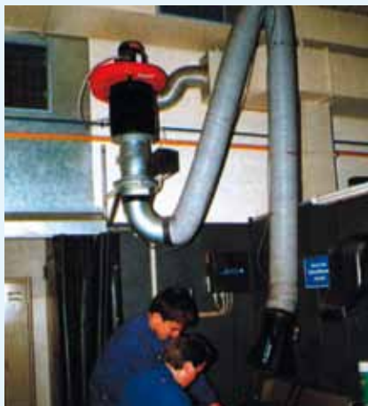
Schweißplatz mit Absaugung und Abführung der gereinigten Abluft ins Freie. Die Arbeiter sollten natürlich nur mit ausreichender Schutzkleidung und -ausrüstung arbeiten!
