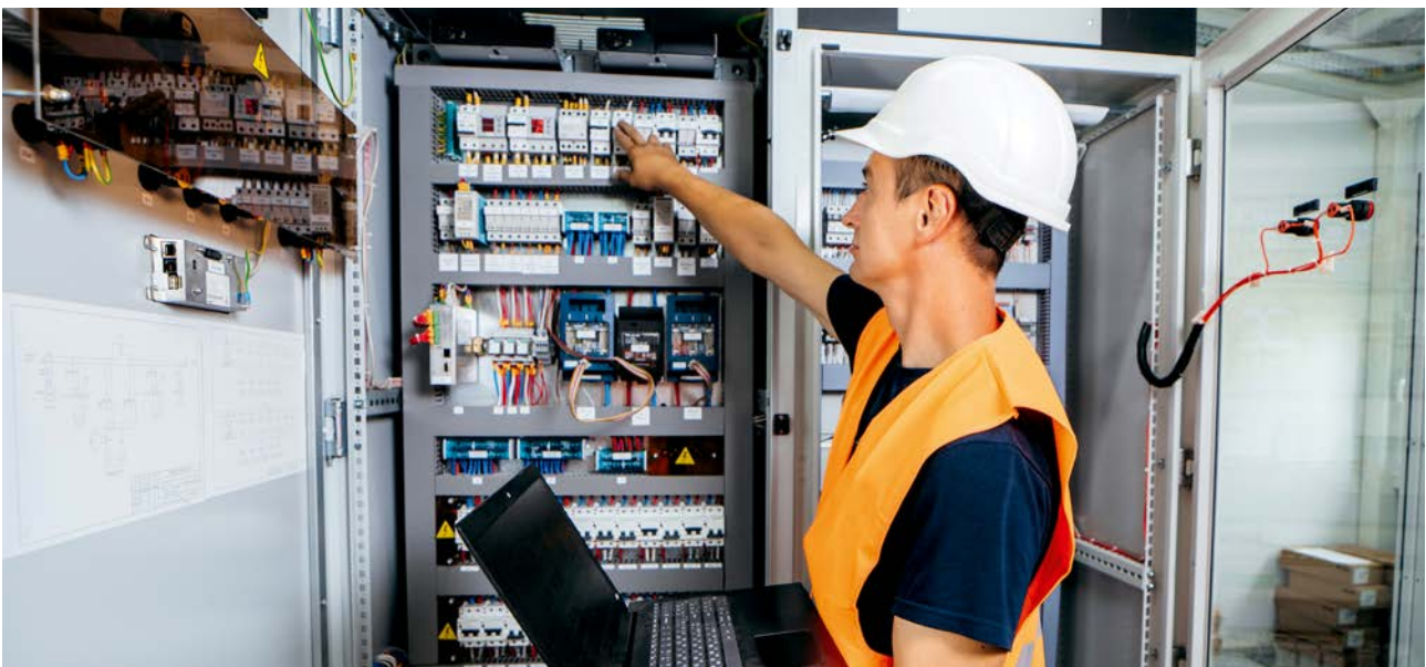
Prüfung eines Schaltkastens mittels Messgerät
