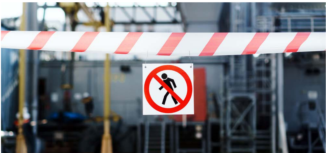
Bereiche sind gegen Zutritt Unbefugter zu sichern und gut sichtbar und dauerhaft kennzuzeichnen.
