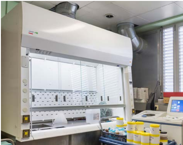
Abb. 28: Ideal ist eine Entsorgungsstation mit Absaugung
