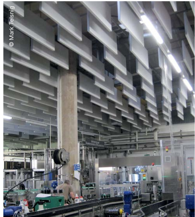
Abb. 11: Baffeln werden häufig in Produktionshallen mit hohen Decken verwendet.
