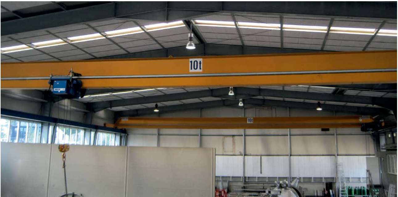
Abb. 15: Umsetzung von Schallschirmen in einer Halle. Wichtig ist, dass eine schallabsorbierende Decke vorhanden ist und auch der Schallschirm mit schallschluckendem Material ausgestattet wird.
